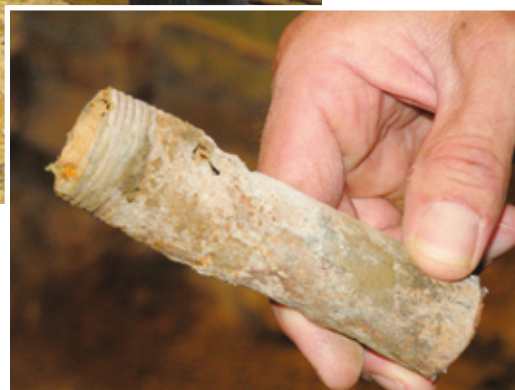
De gamle jernrør, der har siddet i betonen i flere end 30 år, er simpelthen tæret.
